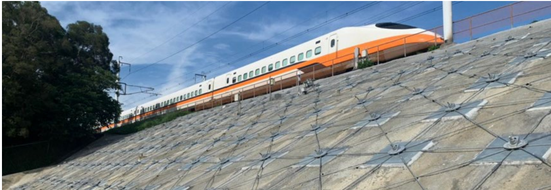
台湾新幹線苗栗地区対策工（GNSS設置）
